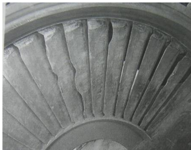
Вмятины, опиления, эрозионные промывы направляющих лопаток диафрагмы ступени 27 ЦНД (ТА К-210-130, 205 МВт)
