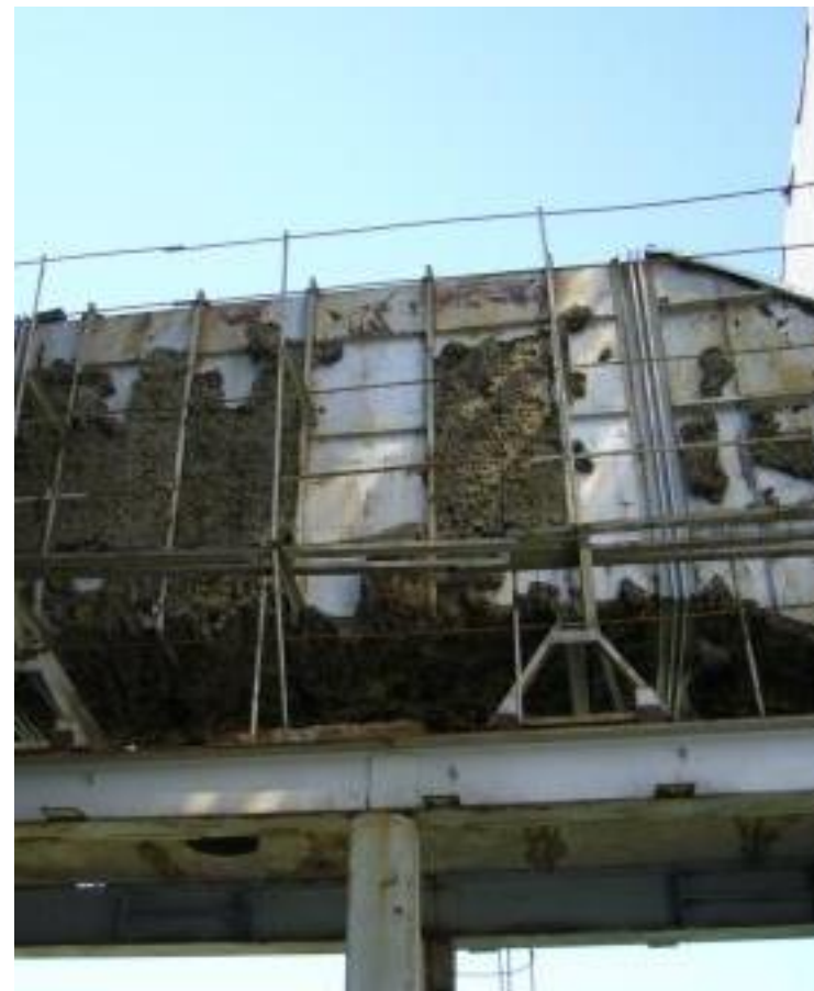
Разрушение покровного слоя и тепловой изоляции с оголением металлоконструкций газохода котла
