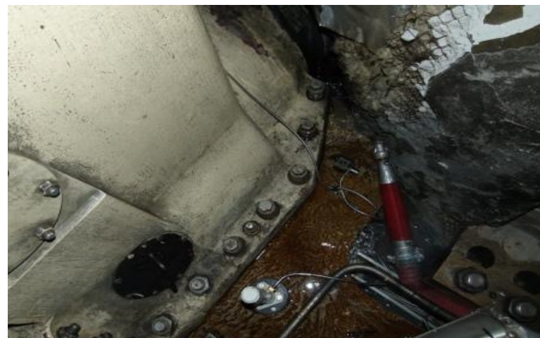
Фото 4. Подвод воды для предотвращения возгорания промасленной тепловой изоляции турбины
