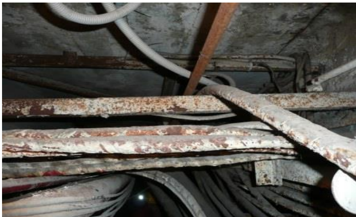
Фото 1. Не обработана лаками и красками броня кабелей
