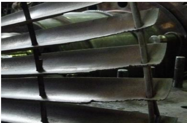
Фото 3. Эрозионное повреждение лопаток РНД турбины
