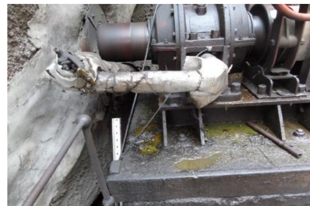
Фото 2. Протечки масла из подшипника дымососа № 1Б
