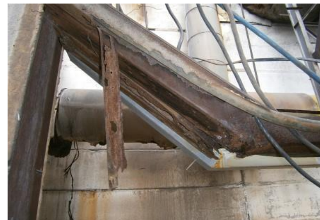
Фото 1. Коррозия кабельного короба
