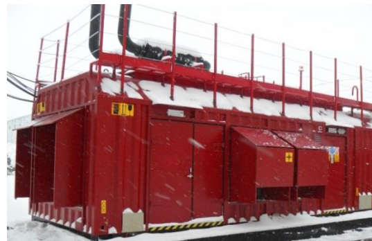
ДЭС-1 «Энерго-1200/6,3КН30» ДЭС-2 «Энерго-1200/6,3КН30» ДЭС-3 «Энерго-1000/0,4КН20»
