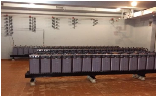
Аккумуляторная батареи ст. № 1 на ВТЭЦ-2
